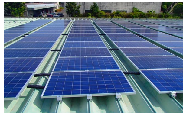
太陽光発電設備
