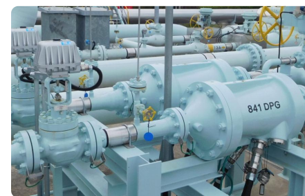
ガス差圧発電設備
