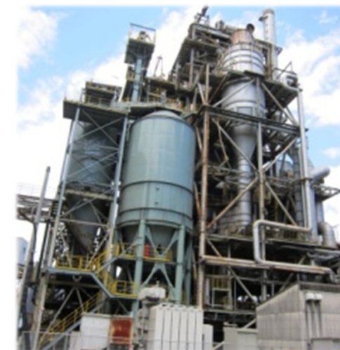
▲ 土佐発電所外観
