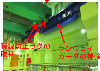
天井クレーン （写真は反対側の部分）
