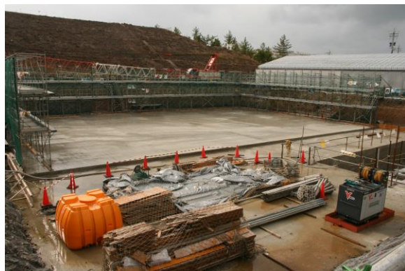
緊急時対策棟の南側（容量 5,100 m 3 ）と東側（容量 4,900 m 3 ）の標高 21m地点に建設中 （写真：南側の建設現場。11月末現在）
