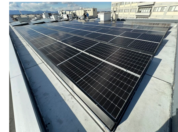
※病院の屋根付け太陽光パネル施工実績
