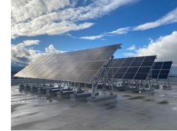
太陽光パネル
