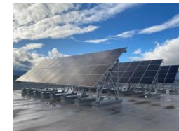
太陽光パネル
