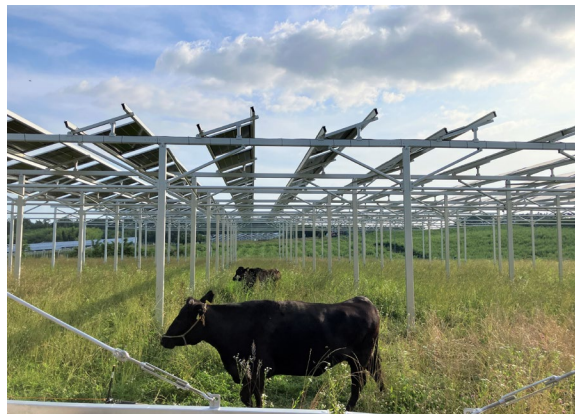
取得した営農型太陽光発電所
