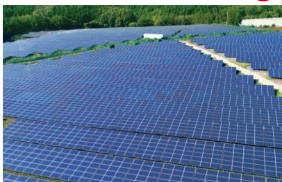
S-05 銚田太陽光発電所
