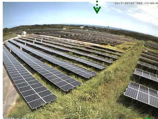
WEBカメラによる発電所の様子
