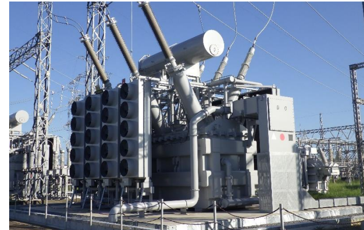
6号変圧器（275kV/154kV、450MVA）
