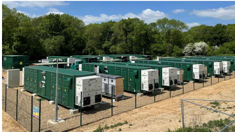
蓄電所（49.5MW/49.5MWh）全景
