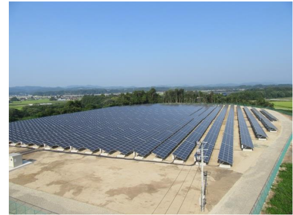
新規に売電を開始した神奈中岩手県金ケ崎太陽光発電所
