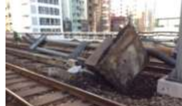
山手線神田～秋葉原間電化柱倒壊
