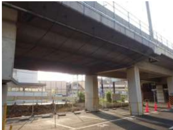
高架橋等落下物対策
