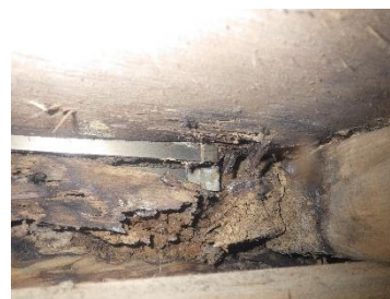
シロアリの被害を看過した事例。木部の交換を含む大規模な補修工事を実施した
