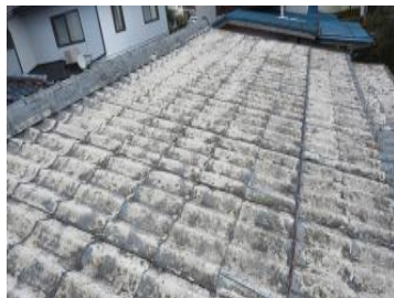
販売後に発見した屋根材の劣化事例。一部補修が出来ず全面的に葺き替えた
