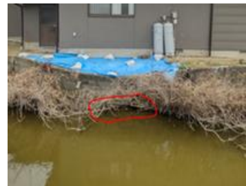
水路の浸食による宅地の被害が発覚した事例。護岸工事により多額の費用が発生した
