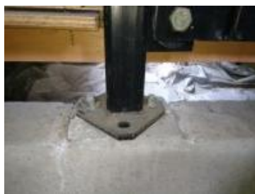
仕入後に改めて不安定な基礎が発見された事例。補修してからの販売となりコスト増となった
