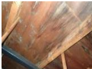
販売後に発生した雨漏りの事例。瑕疵担保責任(当時)により全面補修した
