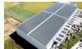
自家消費／武智発電所 容量：417.45kW
