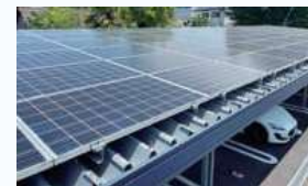
自家消費／カーポート 容量：DC99.84kWAC49.5kW
