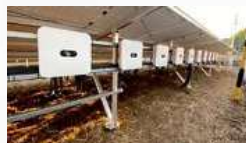
設備運転管理
