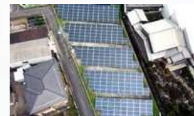
笹野発電所 容量：77kW
