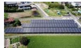
津島下新田発電所 容量：106.5kW
