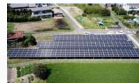
津島下新田発電所 容量：106.5kW
