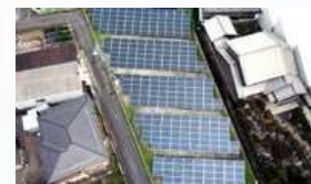
笹野発電所 容量：77kW
