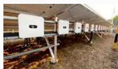
設備運転管理
