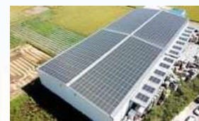
自家消費／武智発電所 容量：417.45kW
