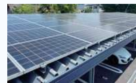
自家消費／カーポート 容量：DC99.84kWAC49.5kW
