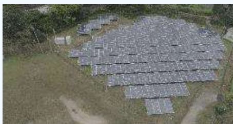
定格出力：350kW 取得日：2020年6月
