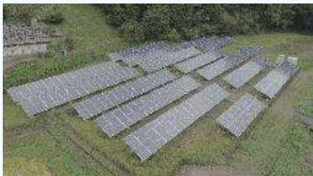
定格出力：250kW 取得日：2020年6月
