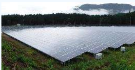
定格出力：1,990kW 取得日：2019年9月
