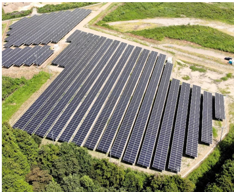
鹿沼市上石川太陽光発電所 全景
