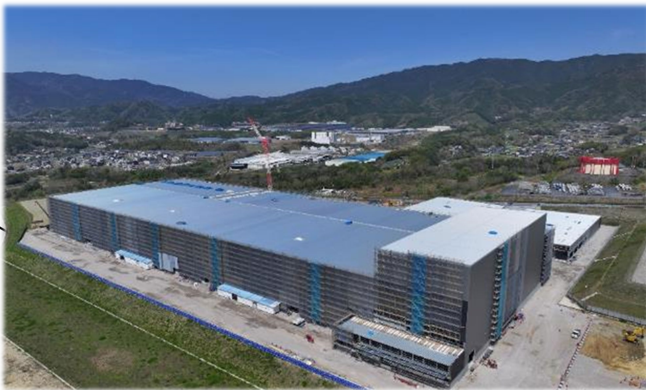
<新関西流通センター 2026年春稼働予定>
