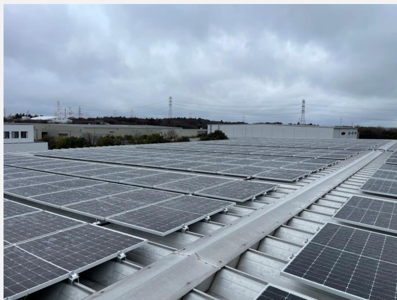
2024年3月完成 千葉物流センター太陽光発電設備
