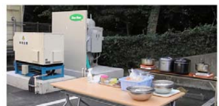
プロパンガス式自家発電機を活用した炊き出しの様子
