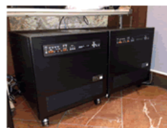
リチウムイオン蓄電池
