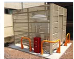
災害バルク貯槽(ガス燃料タンク)
