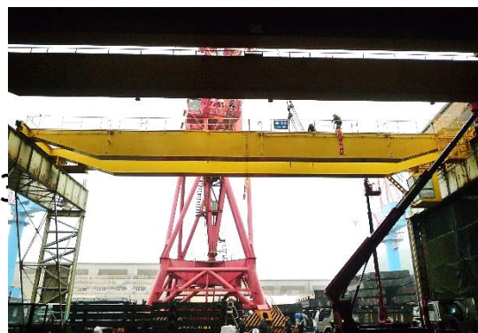
(30ト天井クレーン)
