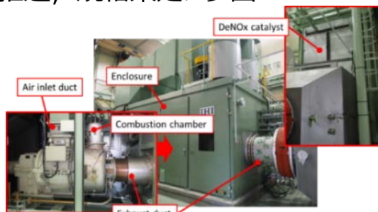
2MW級アンモニア混焼ガスタービン
