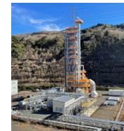
関西電力(株) 舞鶴発電所内実証設備
