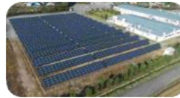
朝日電子(株) 太陽光発電システム
