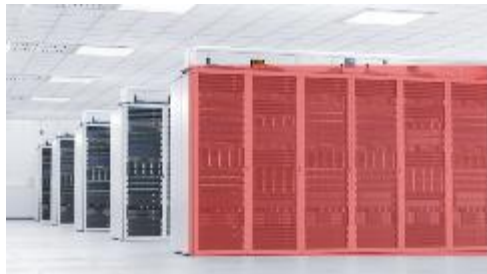
データセンターでの侵入検知例
