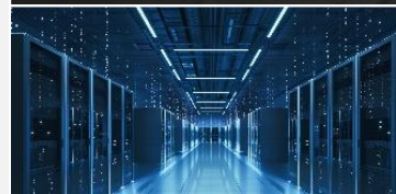
データセンター
