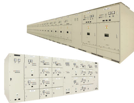
産業用配電制御システム
