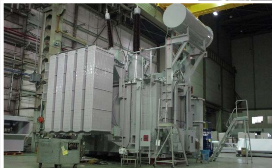
海外向け大型変圧器
