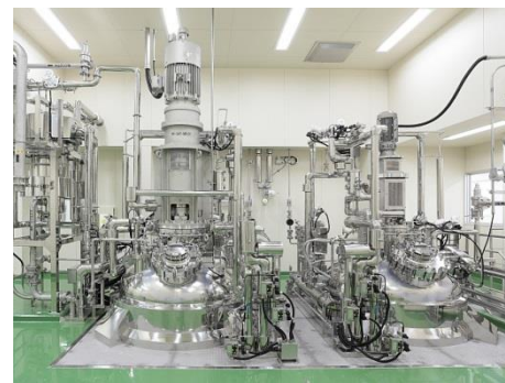
バイオ 培養量産設備
