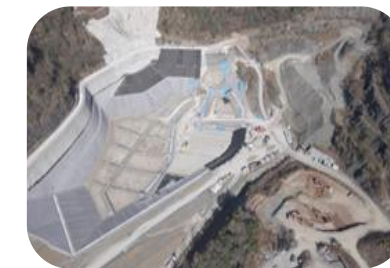
奥山の杜CC（最終処分場）
