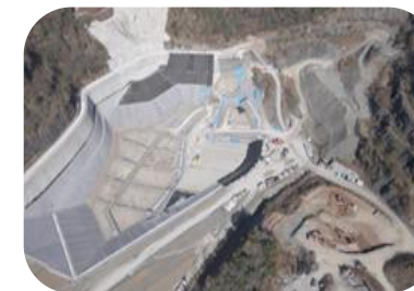
奥山の杜CC (最終処分場)
