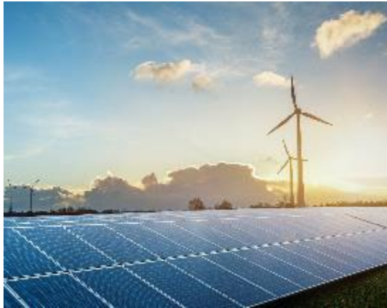
太陽光パネル
