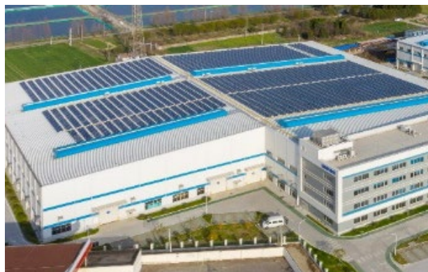
自動車生産ライン向けシステムの工場 （中国・常熟）の屋根に太陽光発電 システムを設置（2021年）
