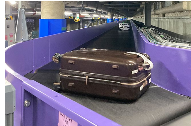
手荷物搬送システム
