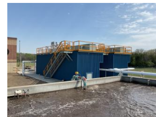
米国で稼働中の グラニューール形成槽
