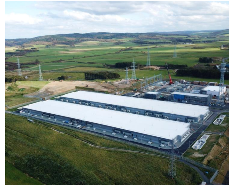
北海道北部風力送電(株)殿向け蓄電池システム建設現場(2020年10月撮影)
