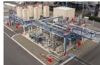
川崎臨海部の脱水素プラント
