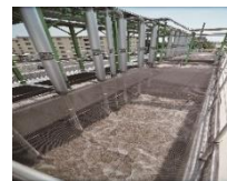
排水処理設備
