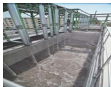
排水処理設備
