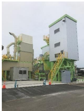
石膏系固化材製造設備等
