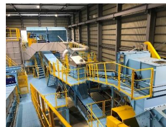
破碎プラント
