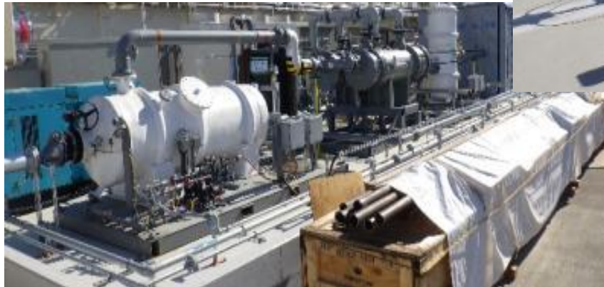
回収した汚染物質の無害化処理装置
