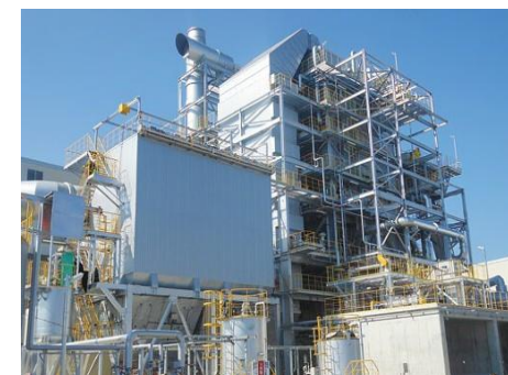
バイオマス発電プラント
