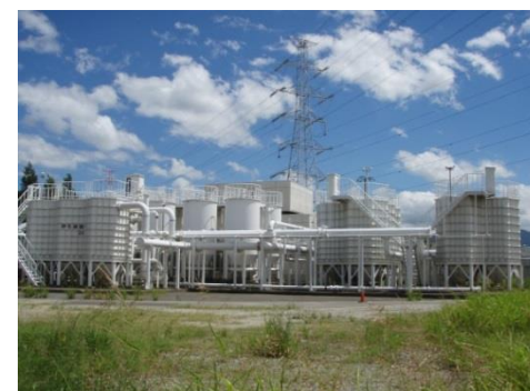
上向流移床型砂ろ過装置
