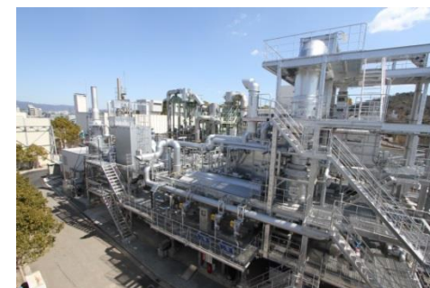
汚泥焼却発電プラント
