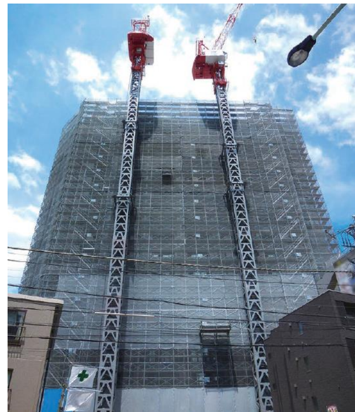
高さ80mのタワーマンション B2階からの立ち上がりの足場部分は最高高さ90m
