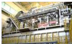
リジエバーナーを 採用した省エネ加熱炉
