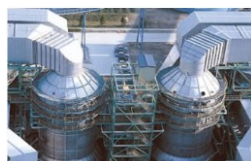
FGD (火力発電所 排煙脱硫装置)
