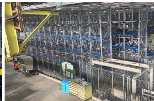
【ロール保管自動倉庫】
