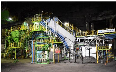
新電気炉外観
