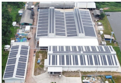
設置された太陽光発電設備
