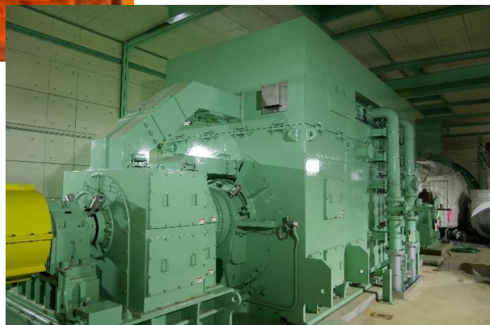
左：燃料投入ホッパへPKSを投入している様子 右：蒸気タービン発電機
